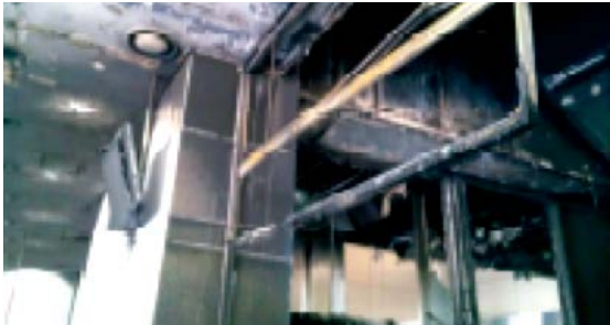
1층 에스컬레이터 방화셔터 미작동
