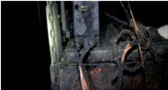
전동리프트에 위치한 전기용접기 사진
